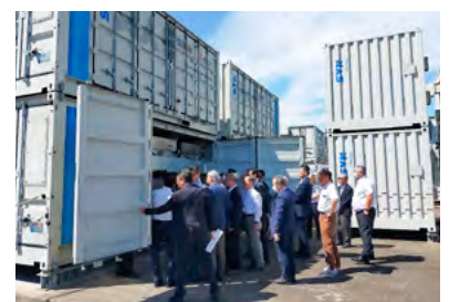
蓄電池ユニット内部の説明を受ける
