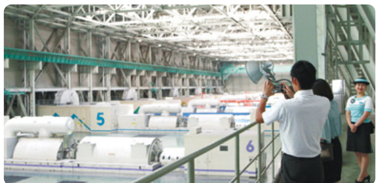
川越火力発電所
